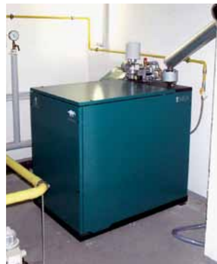
BHKW für mittlere Objekte im Keller eines Verwaltungsgebäudes
