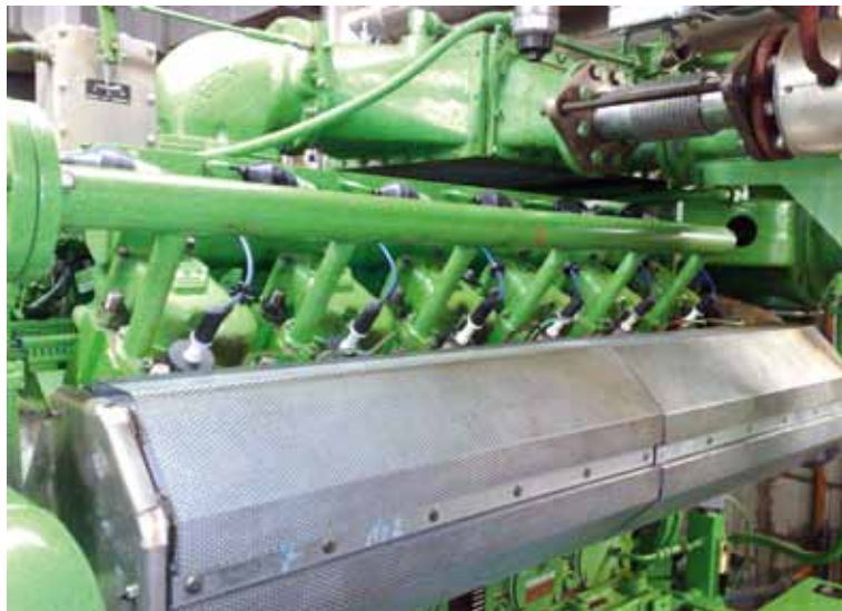
Bioerdgasbetriebenes Blockheizkraftwerk im Palmengarten Frankfurt
